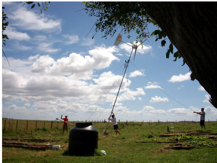
FIG. 18. Aerogenerador 700W instalado por 500 RPM en la estancia El Carrizal.
