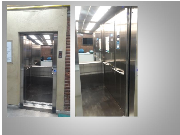
Fotografía 04-Ascensor hidráulico, del Edificio. Elaboración propia.
