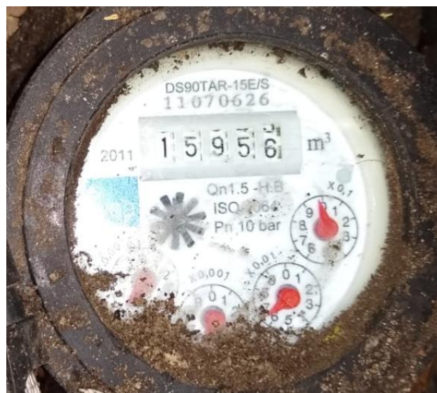
Fotografía 32. Medidor de Agua. Elaboración propia.
