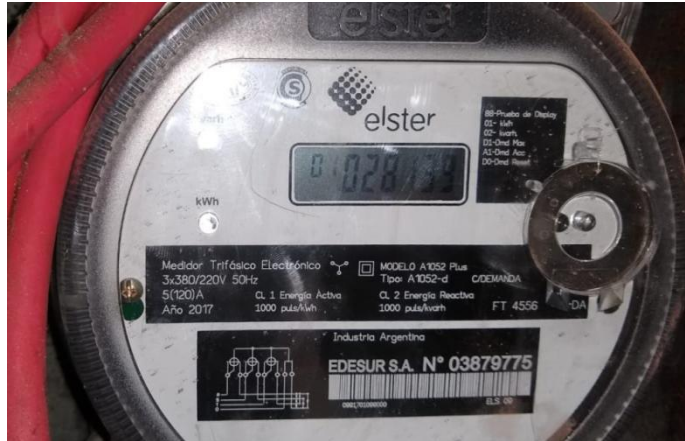
Fotografía 27. Medidor Edesur. S.A. Elaboración propia.
