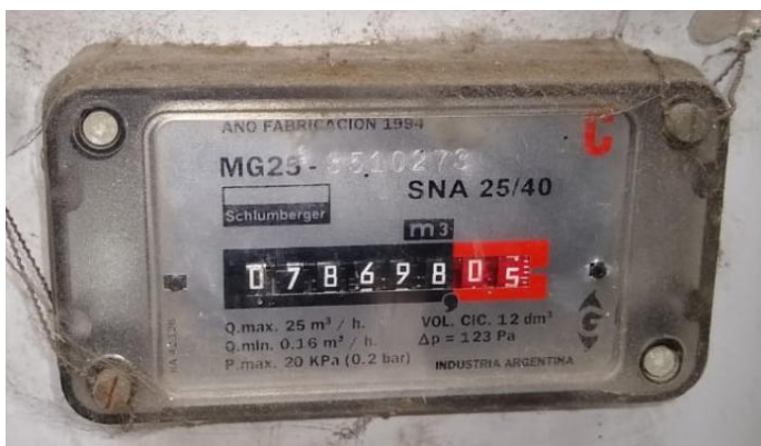
Fotografía 28. Medidor de Gas. Elaboración propia.
