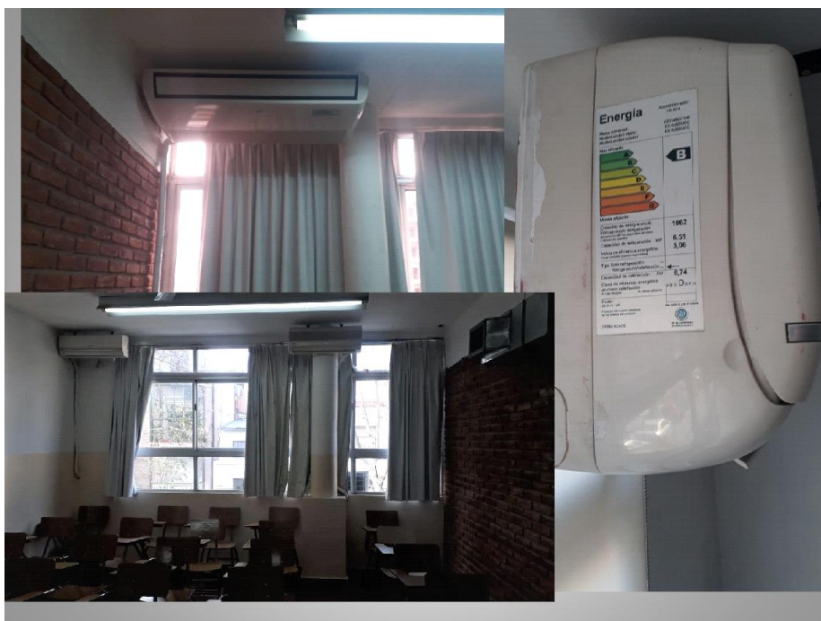
Fotografía 03- Aulas y equipos aires acondicionados
