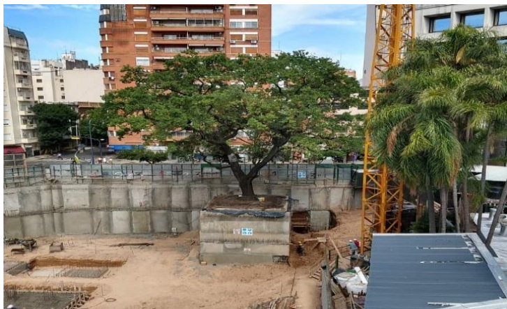
Ilustración 3 - Durante la obra (Fuente Facebook de la página oficial del Hospital Alemán).
