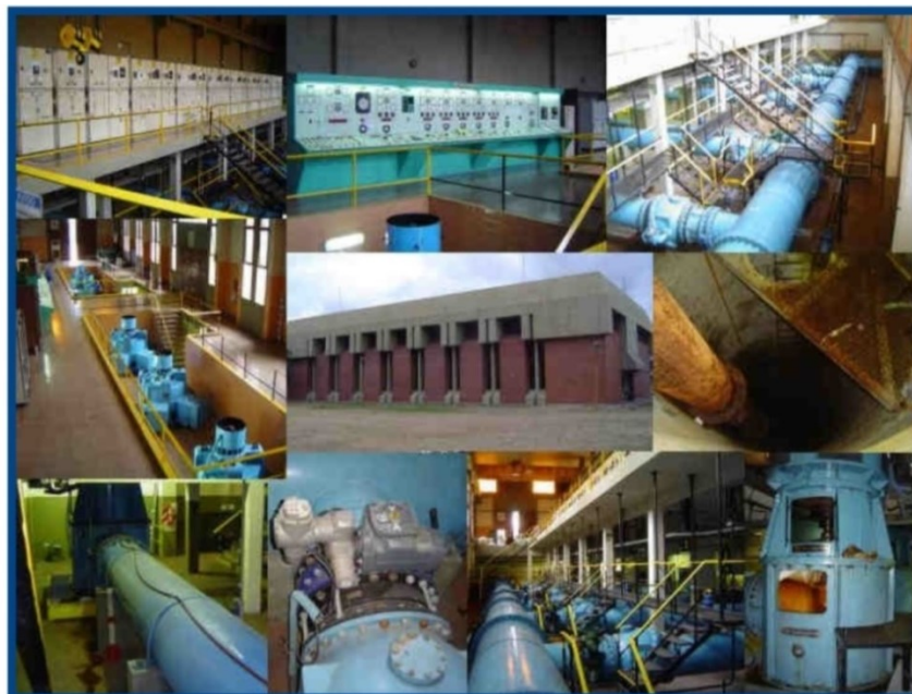
Figura 2. Estación Elevadora La Matanza
