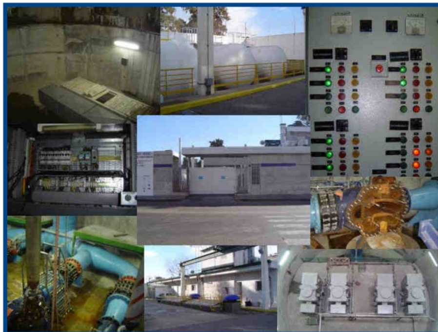
Figura 5. Estación Elevadora Tres de Febrero
