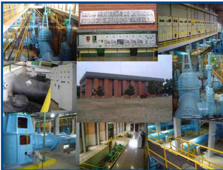
Figura 4. Estación Elevadora Saavedra
