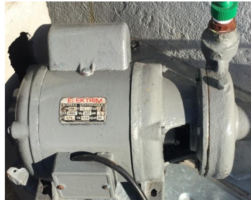
Fig. 11: Bomba centrífuga utilizada para el sistema de riego. Fuente: Fotografía propia.
