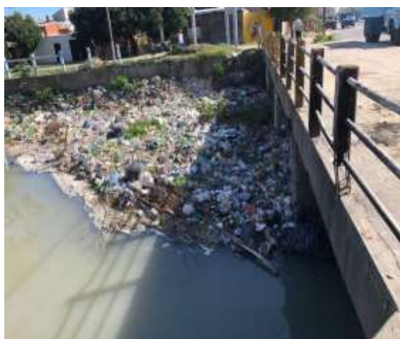
Figura 46. PM4. Bolsas, botellas, animales entre otros residuos retenidos por la retención de neumáticos y ramas.
